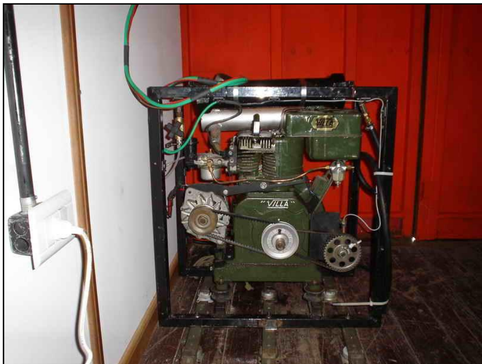
Grupo electrógeno funcionando 100% a hidrógeno
